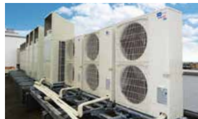
電気式ヒートポンプ
