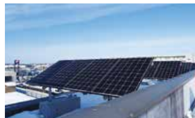
太陽光パネル
