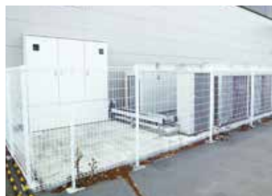
ビル用マルチエアコン室外機
